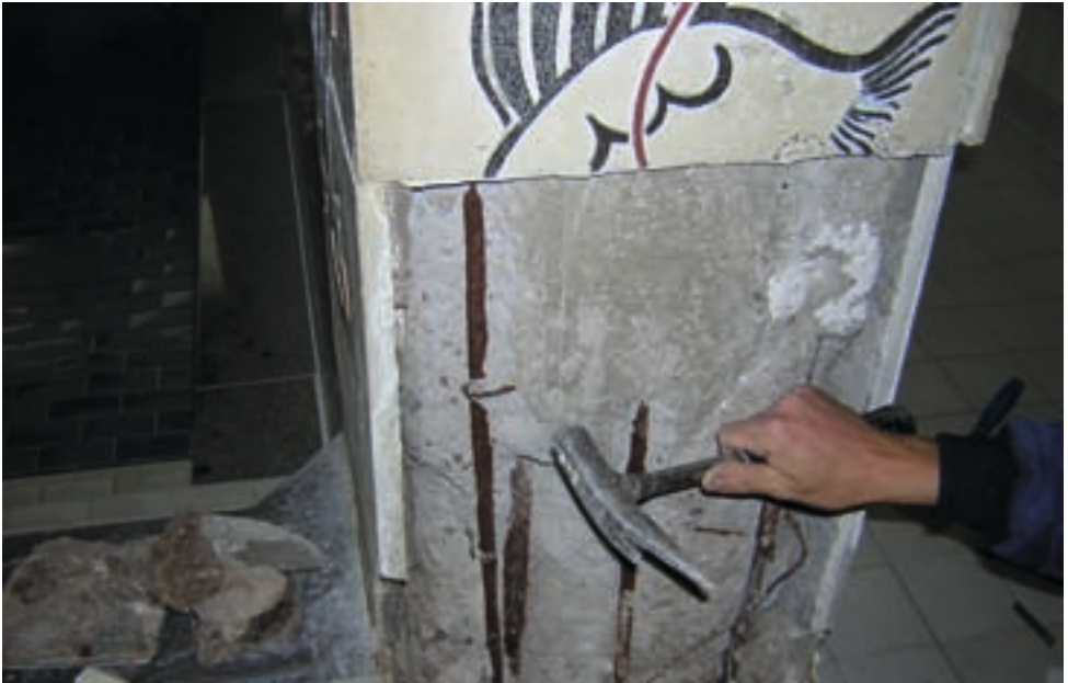
Abbildung 12: Emma-Jaeger-Bad, korrodierte Stütze im Dampfbad, darüber Reliefplatte mit Fisch, 7. Juni 2010 (Untere Denkmalschutzbehörde Stadt Pforzheim)
