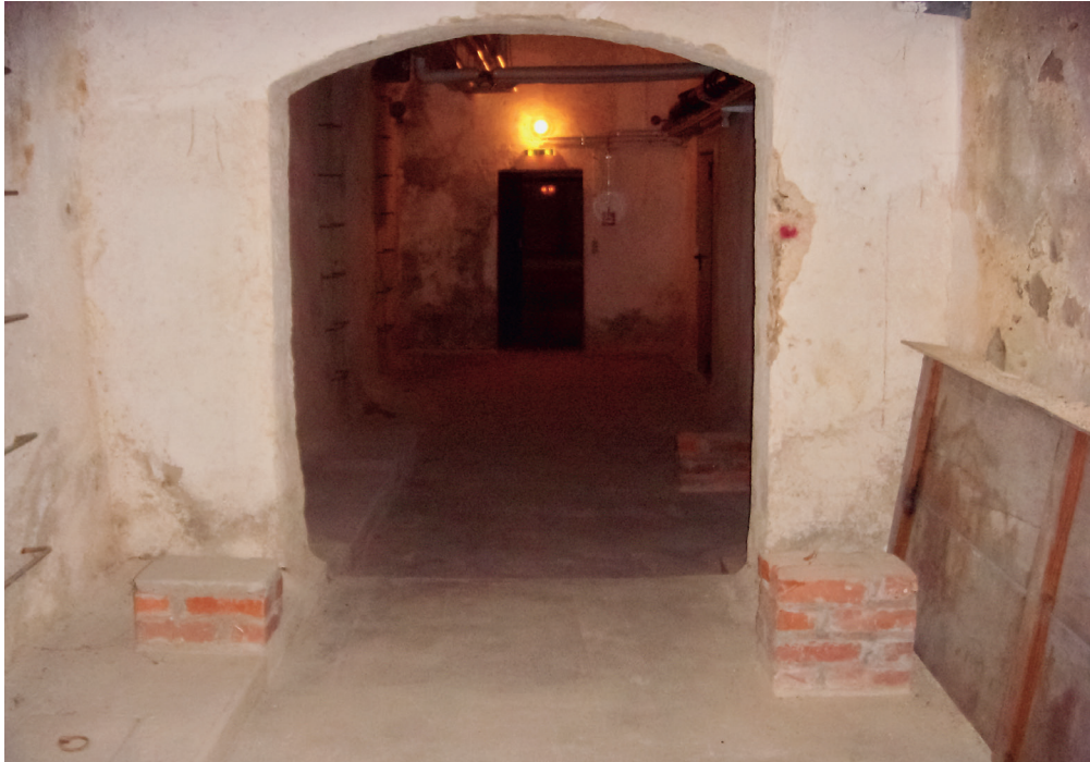
Abb. 2: Kellerraum des Waisenhausgebäudes. Der Raum wurde im Zweiten Weltkrieg als Luftschutzkeller benutzt. Foto: Autorin
